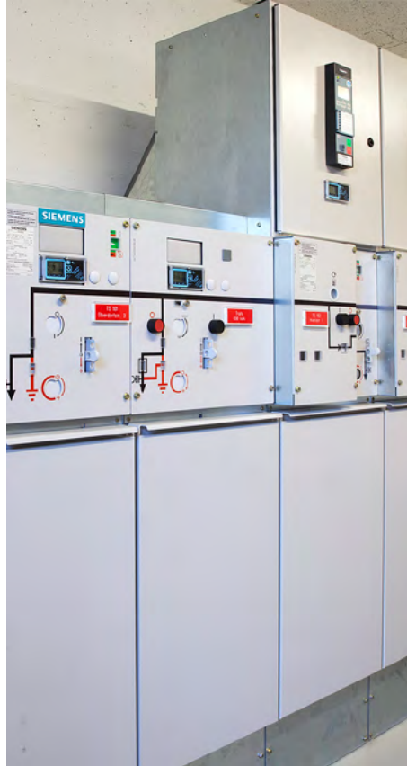
Sanierung Trafostation Alvierweg 1, Mühlehorn. Die alte Anlage (links); die neue Hochspannungs- anlage (rechts).
