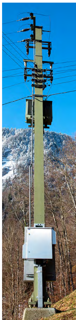
Die Bilder zeigen den Kommunikationsschrank bei einer Trafo-Mast-Station im Oberurner Täli.
