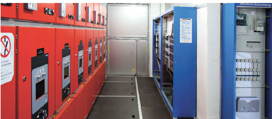
Das Bild zeigt auf der linken Seite die neue Hochspannungsanlage (rot) und rechts die Niederspannungsverteilung sowie die Verteilung für die öffentliche Beleuchtung.
